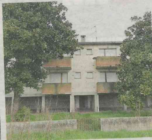
Gli alloggi popolari sono disabitati da tempo e versano in cattive condizioni: i contributi ottenuti tramite il Pnrr ne consentono la riqualificazione
