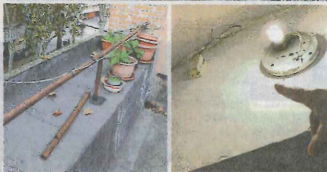
Il condominio di via Foro Boario 50: da trent'anni nessun lavoro
