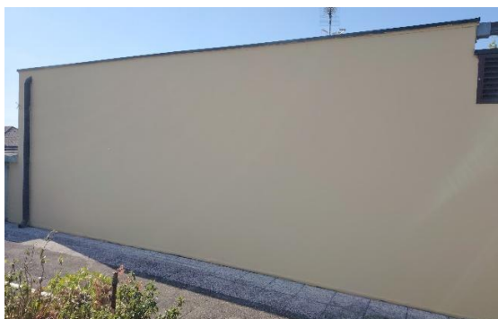
FE- Via Bentivoglio 128 – Tinteggiatura di muro perimetrale
