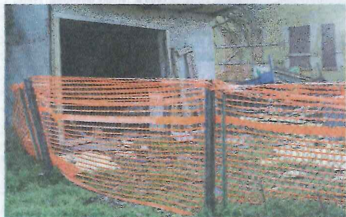
La recinzione messa da Acer per delimitare l'area del degrado a Barco
